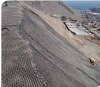
Control de caídas de piedras. Tocopilla - Chile.
