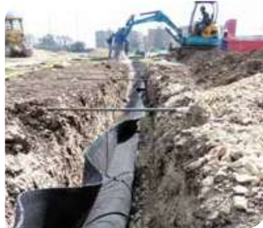
Subdrenaje longitudinal. Bogotá - Colombia.
