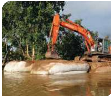
Estructuras de control hidráulico. Bolívar - Colombia.
