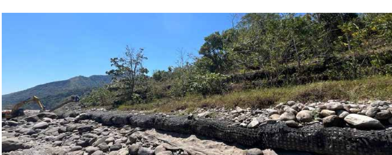
Fotografía 14. Estado actual Enero 2024. Se aprecia la agradación del lecho frente a la estructura.
