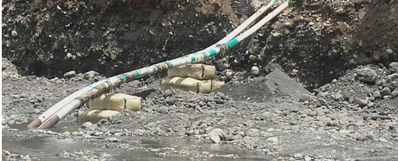
Fotografía 5. Estructuras de soporte con Hydroblocks.
