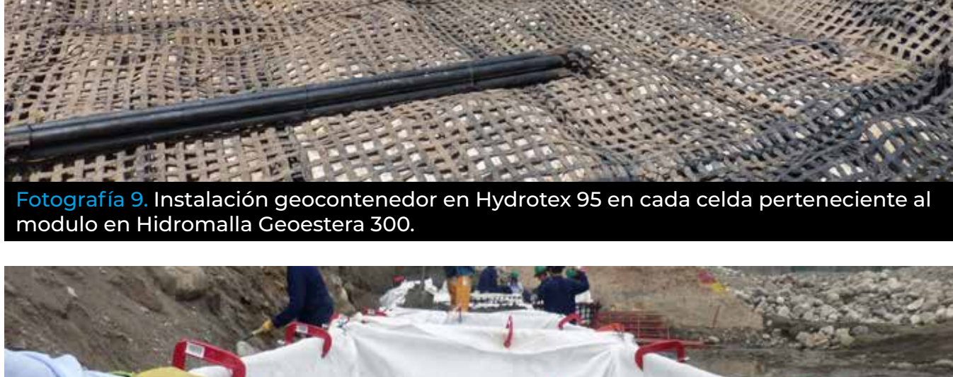
Fotografía 10. Sistema de sostenimiento de los geocontenedores de geotextil y de la hidromalla a la formaleta
