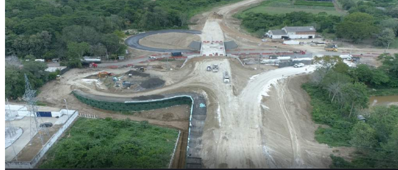
Fotografía 1. Suelo reforzado con geomalla FORTGRID UX y revestimiento en la cara con manto TERRATRAC TRM 15
