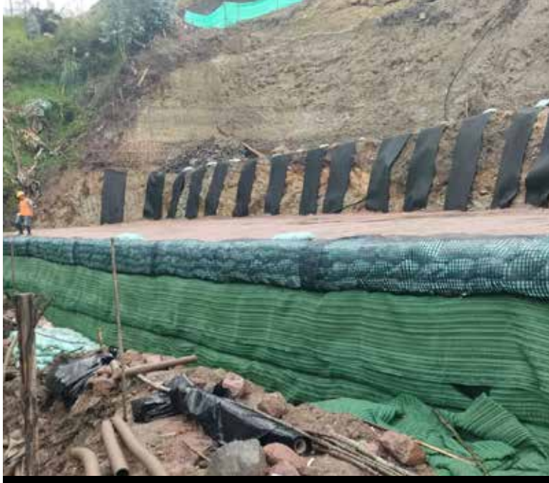
Fotografía 5. Sistema de subdrenaje en el espaldar del muro
