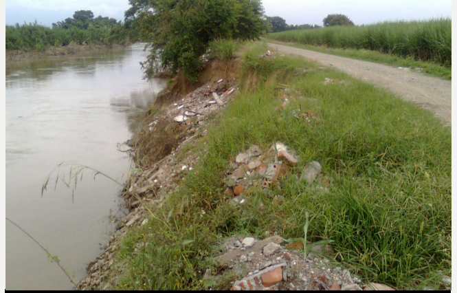
Fotografía 1. Área afectada por la erosión del río.
