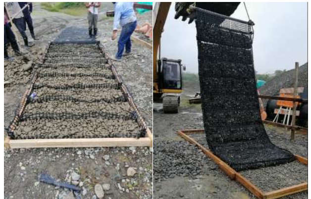
Foto 2-3 Armado del colchón de enrocado en sitio de prefabricación y traslado hacia sitio de pre ensamble con la tubería.
